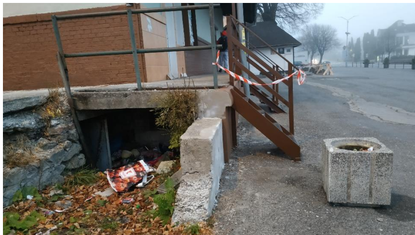
Obr. 31 - Zanedbaný priestor pri rampe
