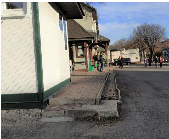
Obr. 16 - Stav nástupišťa 1 PAD
