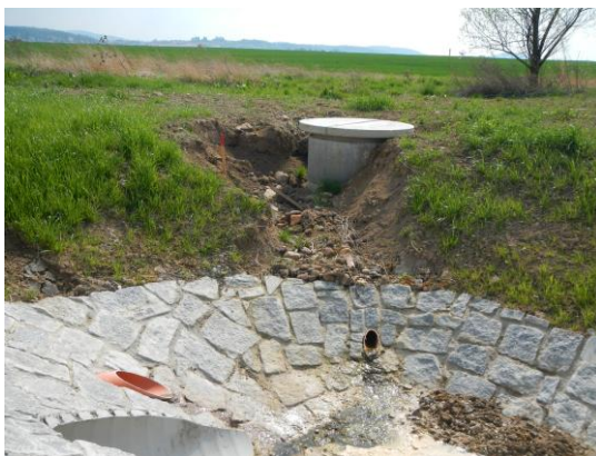
Obrázek 26: Nezasypaná betonová skruž
