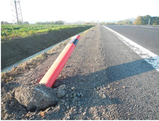
Obrázek 46: Vyvrácený směrový sloupek
