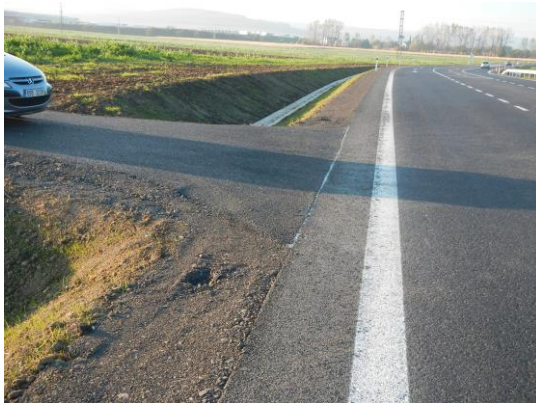
Obrázek 48: Chybějící směrové sloupky
