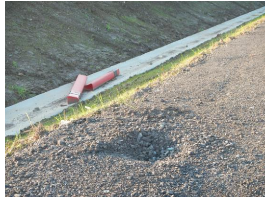
Obrázek 49: Vyvrácené směrové sloupky
