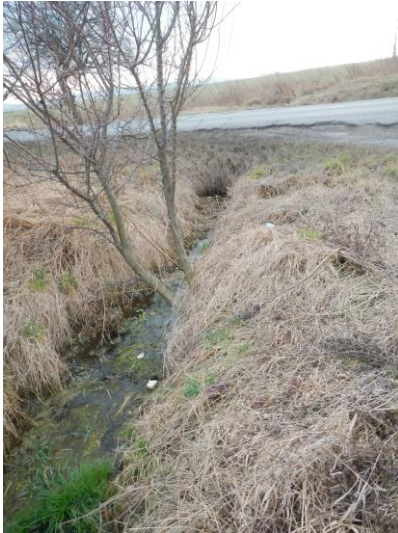
Obrázek 15: Původní odvodnění podél komunikace
