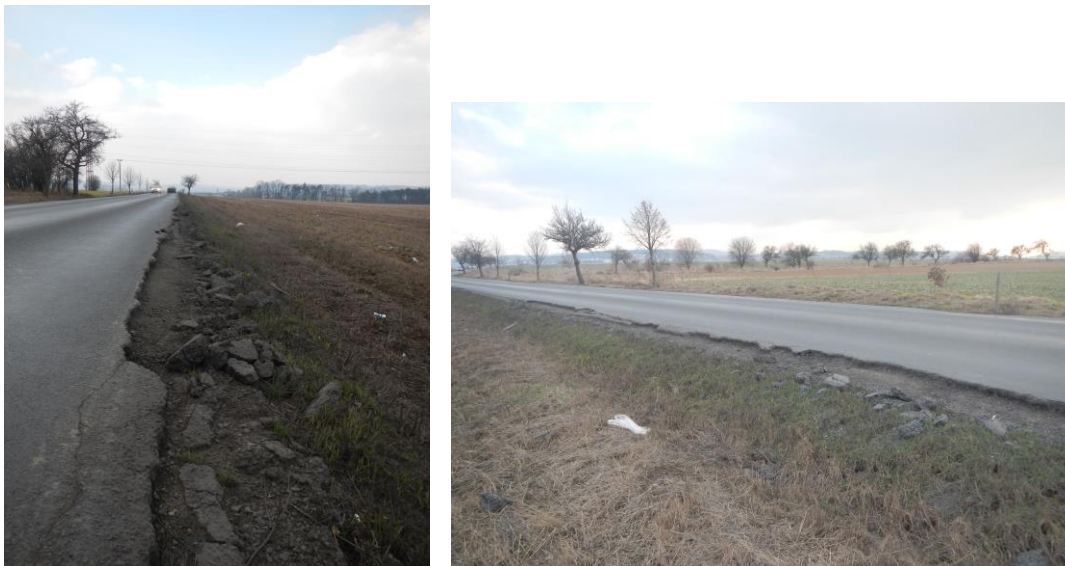
Obrázek 18, Obrázek 19: Katastrofální stav podélné hrany jízdnic pruhů
