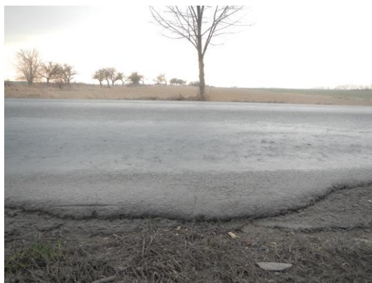
Obrázek 17: Vyjeté koleje s nevhodně zakončenou zpevněnou a nezpevněnou částí komunikace
