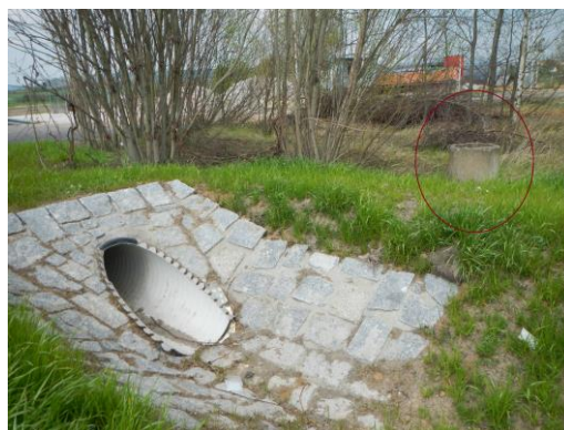
Obrázek 33: Umělá pevná překážka - betonová skruž
