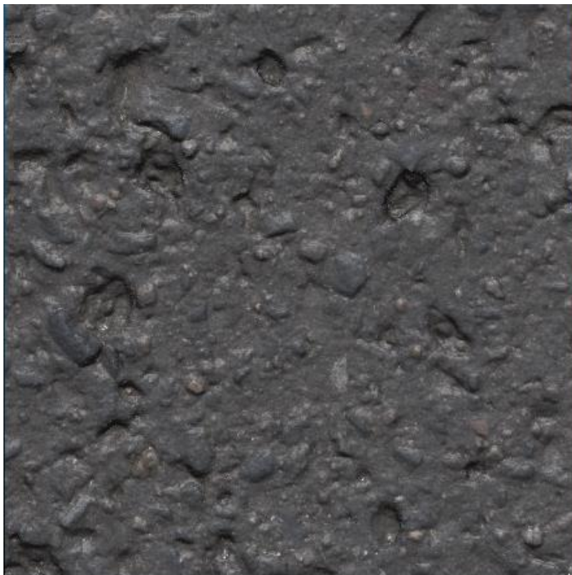
A11 – Model povrchu vozovky osmého měření
