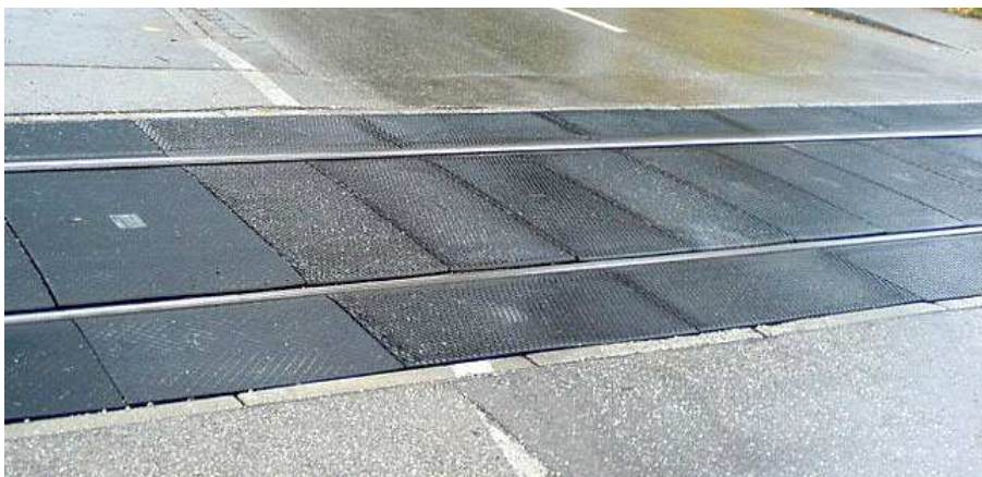
Obrázek 3 – Příklad speciální pryžové úpravy povrchu přejezdové vozovky
