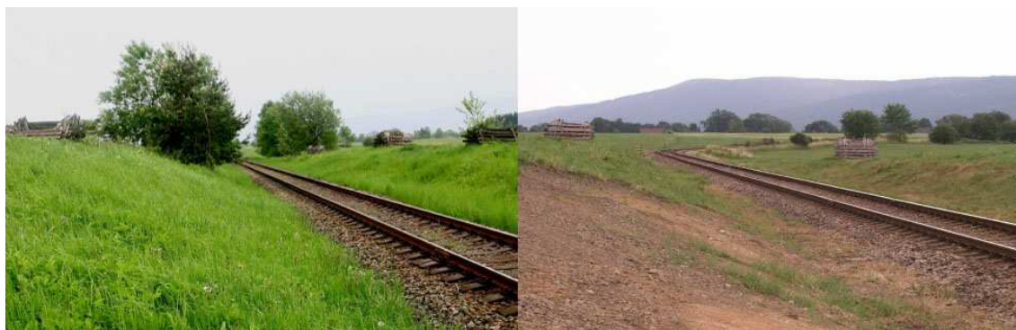
Obrázek 18 – Srovnání kvality rozhledových poměrů na ŽP č. P4170 před a po provedení úprav [7]
