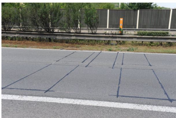
Obr. 45 - příklad použití indukčních smyček ve vozovce, zdroj [13]
