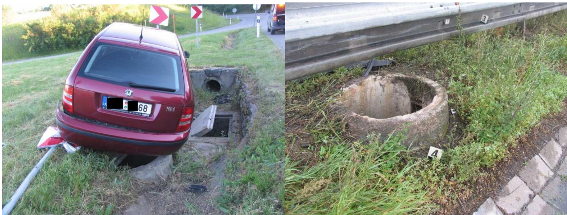
Obrázek 21 Problém 6 – detail betonového vyústění šachty
